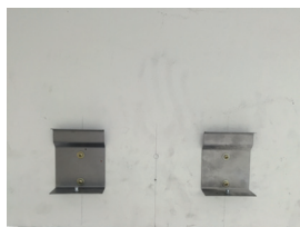
SUSTENTADORES FIXADOS (PAREDE)
